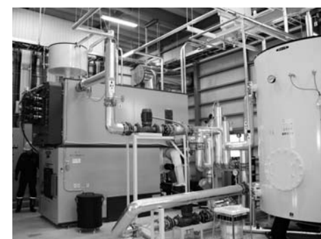
梅里苑・木質チップボイラー
