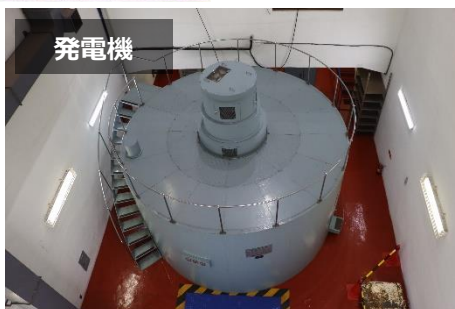
大沢川発電所
