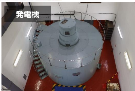
大沢川発電所
