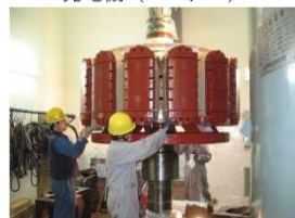
発電機（ローター）
