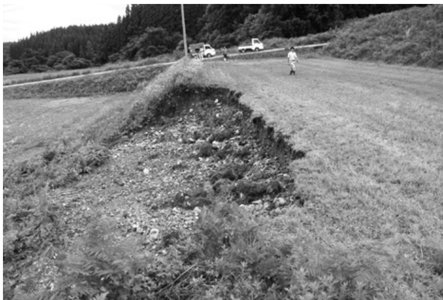
平成30年の豪雨災害(川ノ内地区)
