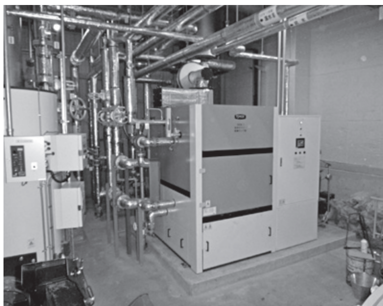
役場庁舎のチップボイラー
