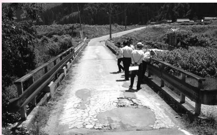
改修が待たれる田代橋
