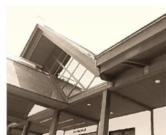
破損した梅里苑屋根
