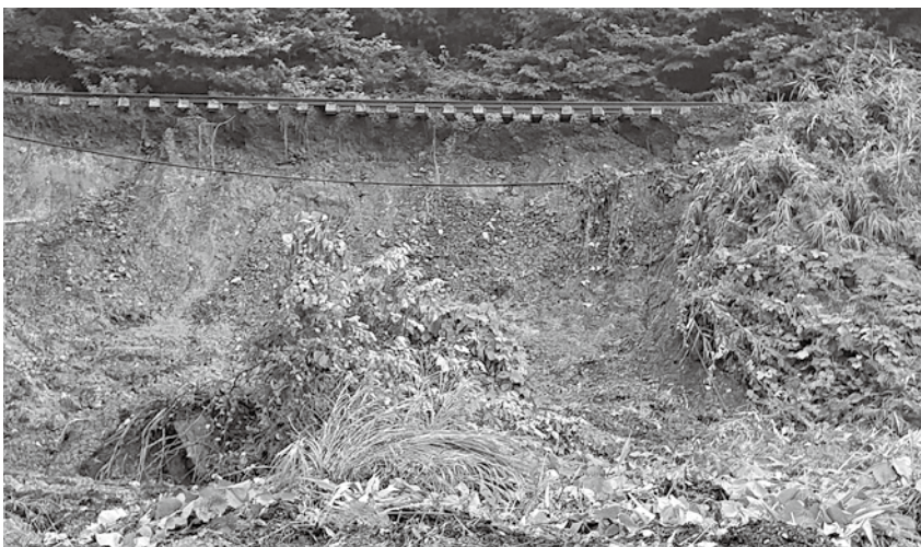
JR奥羽本線の被災箇所(川ノ内下)
