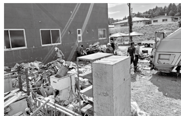
令和6年7月豪雨時の仮置場
